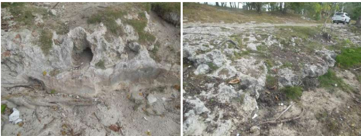
Fotos 2.3.1-3. Calizas fracturadas, carsificadas que se distribuyen afloran al Sur de la zona de estudio (archivos de Empaca).
