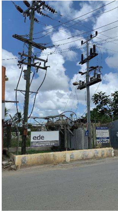
Foto 2.6.7.4-1. Subestación eléctrica de Guerra
