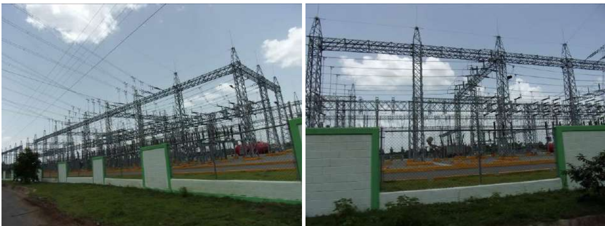
Fotos 1.10.10-1. Subestación localizada en San Antonio de Guerra .
